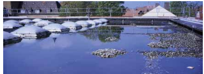
Flachdach ohne Gefälle, stehendes Wasser kann die Tragfähigkeit des Daches negativ beeinflussen.
