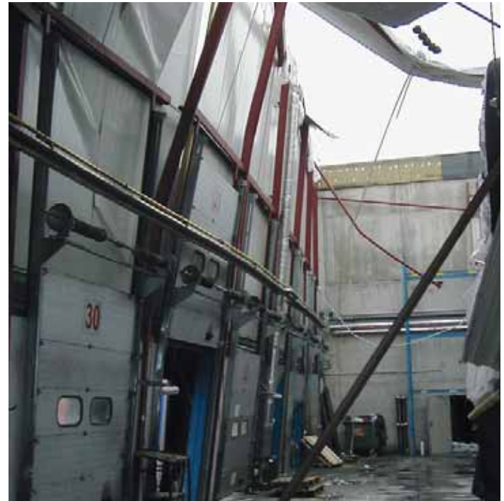
Flachdacheinsturz auf Grund von fehlender bzw. zu kleiner Notentwässerung
