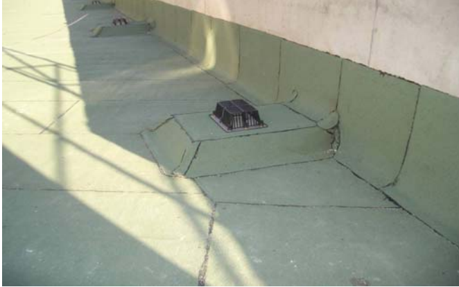
Bild 1: „Warmdach“ im Bereich des Notentwässers (SitaTurbo)
